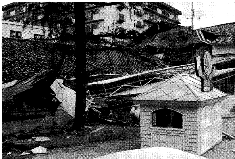
▲倒壊した木造園舎
