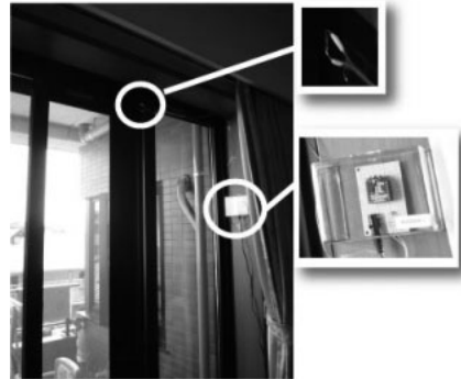
図 12 窓にリードスイッチ (上) と無線モジュール (下) を取り付けた
