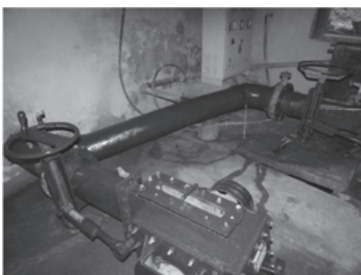
（下段）水力発電所の様子
