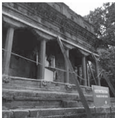
写真2 崩れかけた建造物と立ち入り禁止を 示す看板
